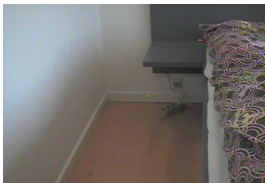
Billede 5: Soveværelse, utæt overgang mellem gulv og væg.
