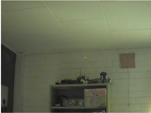
Billede 1: Davids værelse utæt mellem væg og loft.
