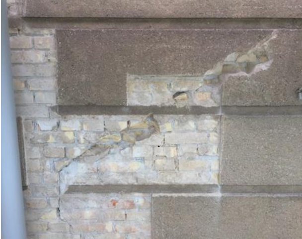
Partiel fjernelse af nedbrudt og skruk puds.
