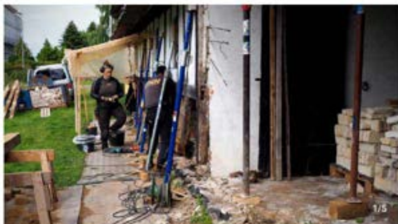
Håndværkere fra H&H Tømmer og Bindingsværk er i gang med at skibe bundremmen på bindingsværket i syd-længen. Foto: Maria Reloft Pedersen
